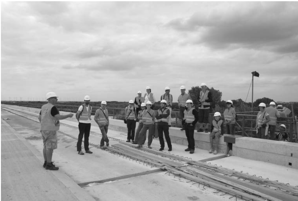
BBN-Regionalgruppe Sachsen-Anhalt mit Herrn Udo Koppernock (Bauüberwachung Saale-Elster-Talbrücke, ingeBÜSet) auf der Baustelle der Saale-Elster-Brücke
